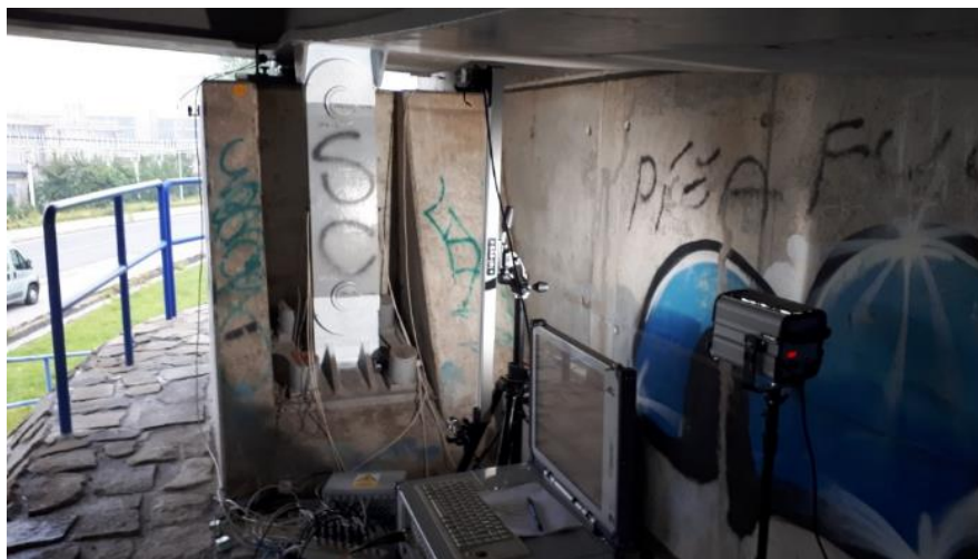
Obr. 6: Aplikace metody korelace digitálního obrazu při sledování polí poměrných deformací a posunů na čepch kotvení mostu na krajní opěře.
