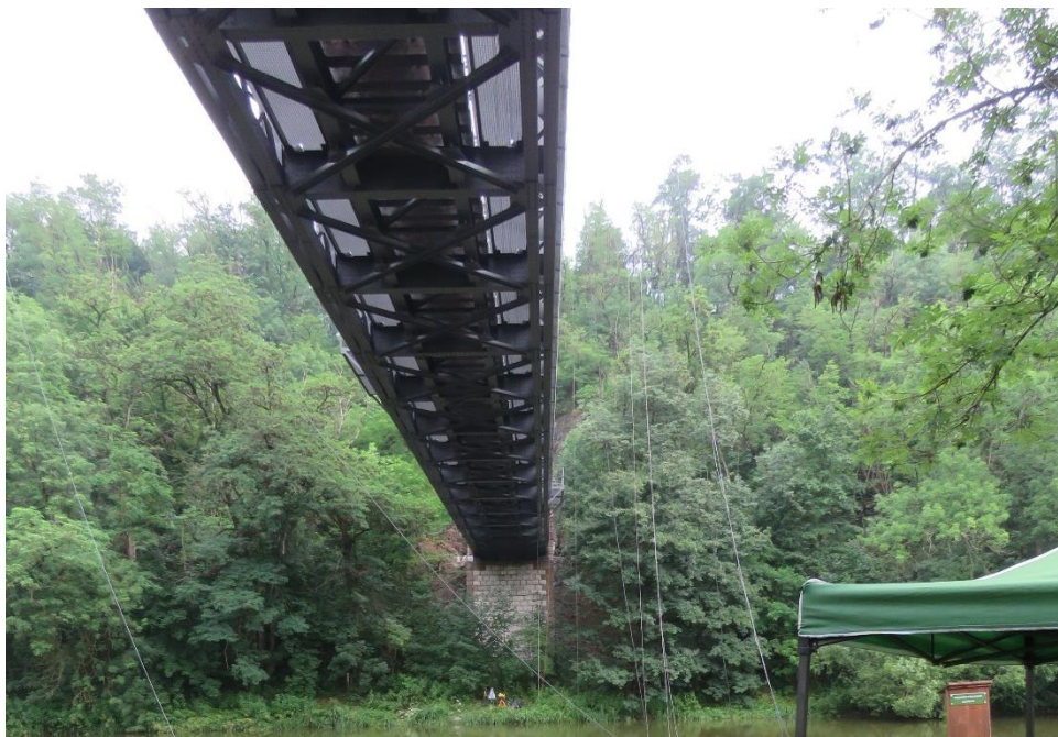
Obr. 10 – Pohled na ocelové příčníky mostu z pozice blízké stanoviště radaru R 2 (pohled proti směru staničení mostu od Ratajů směrem k tunelu).
