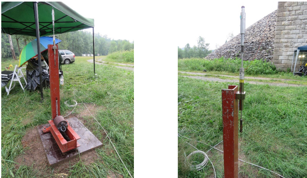
Obr. 13: Relativní snímač dráhy – celkový pohled na ocelový rám umístěný ve vztažném bodu pod sledovanou nosnou konstrukcí železničního mostu v Ratajích (vlevo) a detail induktivního snímače dráhy LVDT-ISDL-50-KD-2405 upevněného v ocelovém rámu s jádrem a verifikačním přípravkem (vpravo).
